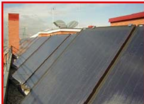
Moc: 150 Kolektorów słonecznych
